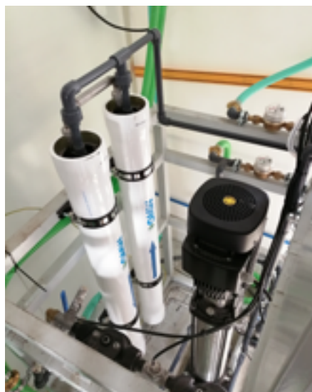
» Miniúpravna vody v moldavském Oracu skrývá české know-how. Foto: VODNÍ ZDROJE
